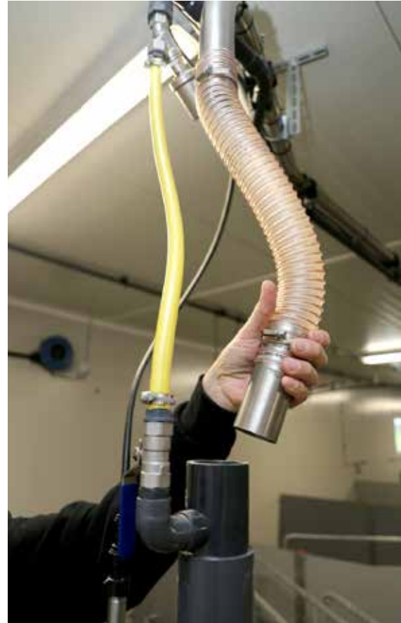
RENSLIG: Det er lett å kople av siste meter'n med føringsrør over krybba. På bildet sees slangen med vanntilførselen.
