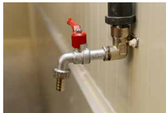
RENSLIGHET: En vannkran på vegg ved dørene mellom avdelingene gjør det enkelt å spyle gummistøvlene.
