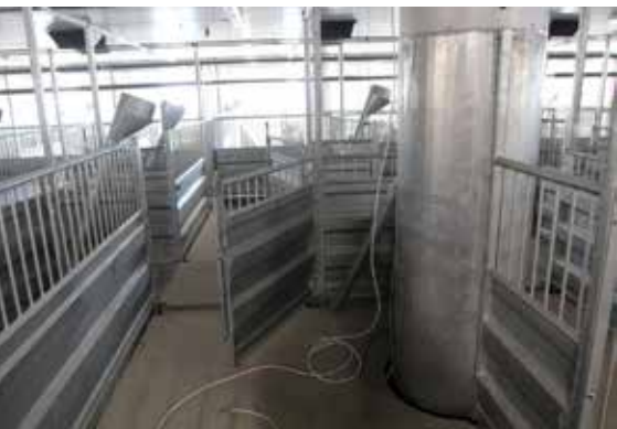
OPP OG UT: Ventilasjonslufta suges ned gjennom ristearealet og under bingene før den føres opp over tak i den runde ventilasjons-pipa som sees i denne rånebingen.
